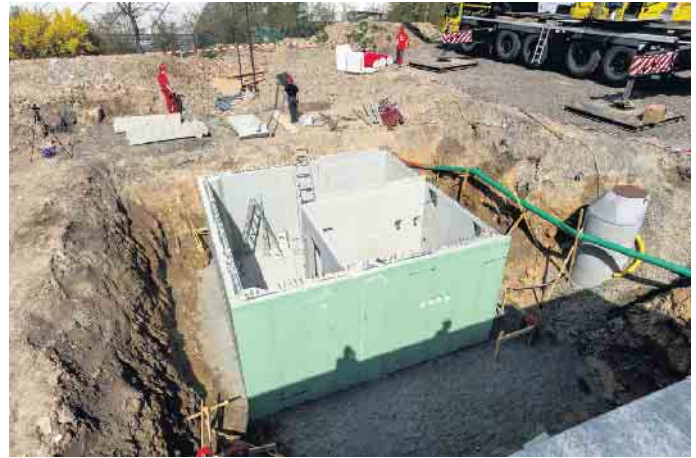
6,50 mal 6,50 Meter Baugrube reichen für einen kompakten Teilkeller meist schon aus. Foto: GÜF/Glatthaar Keller
